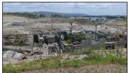
ガトゥン湖側第三閘門建設現場 (写真提供：柴崎隆一 (OCDI) 2013.4)
